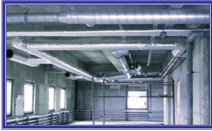
Resim 4.6: Depo havalandırma sistemi
