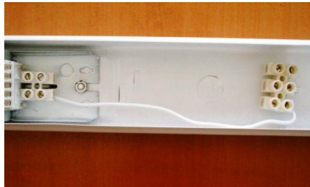
Resim 4.17: Balasta faz kablosunun bağlantısı
