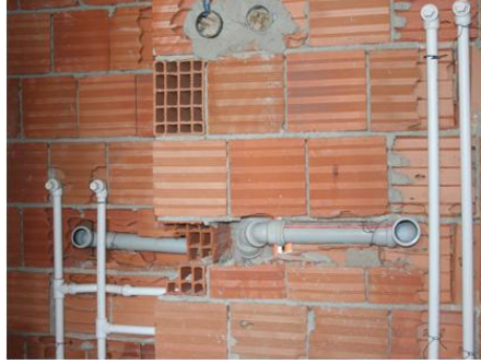
Resim 1.1: Bina içi ankastre sıhhi tesisat yapımı, temiz su ve pis su boruları
