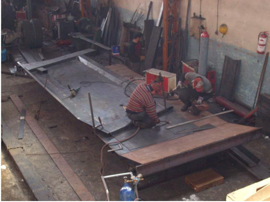
Resim 1.7: İşkençe ile sabitlenmiş sacın kaynakla montajı
