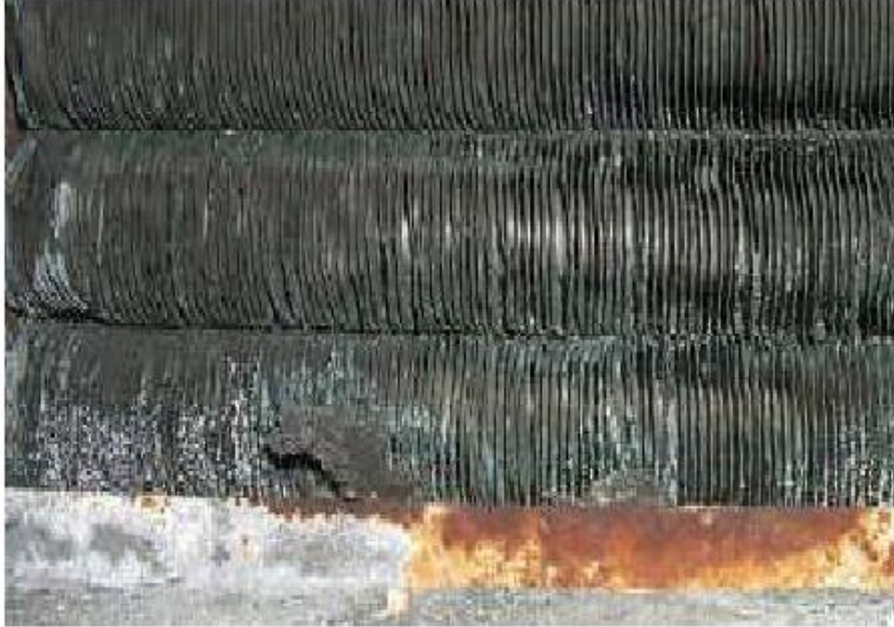
Resim4.1: Kondenserin korozyona uğramış hali
