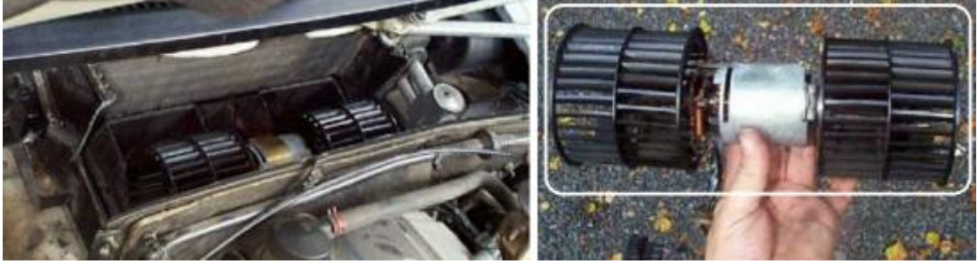
Resim 3.21: Evaporatör, evaporatör fan motoru ve fanların kontrolü
