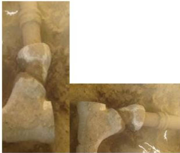
Resim 5.1: PVC borunun kanalizasyona bađlanması
