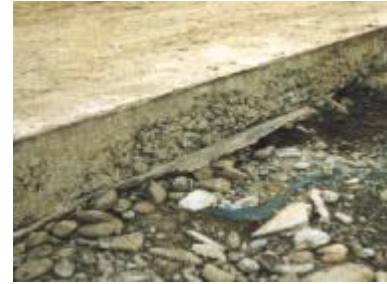
Resim 33: Yanlış Uygulanmış Grobeton
