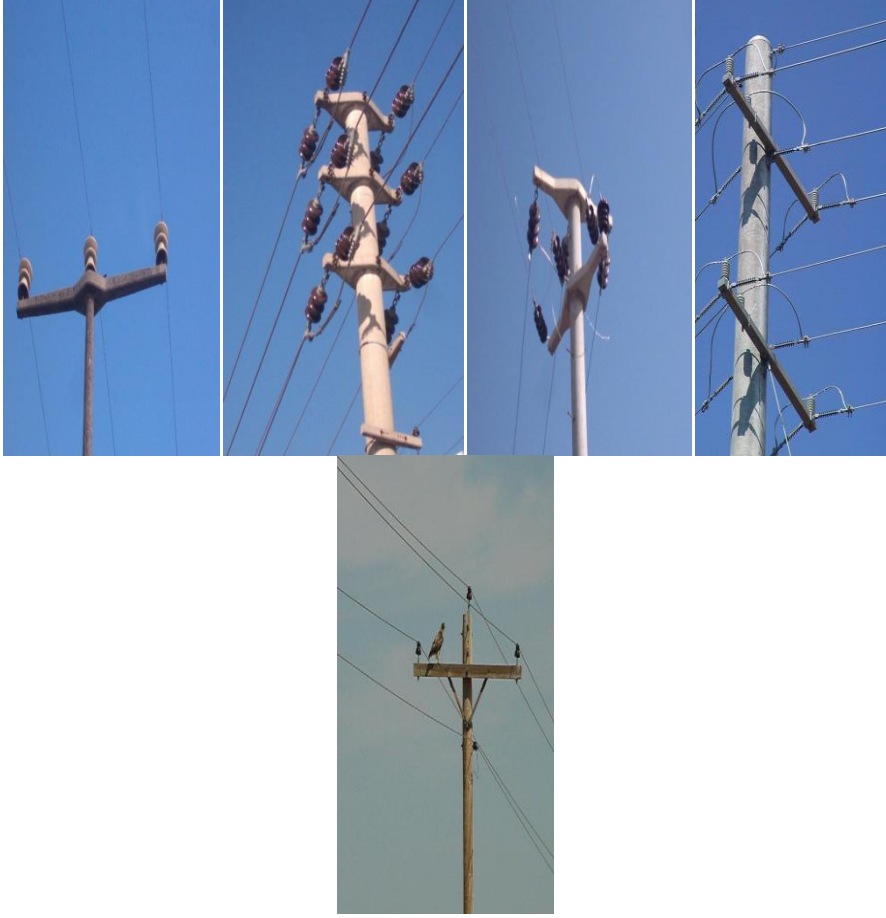
Resim 1.16: Direklerde beton, demir ve ağaç traversler
