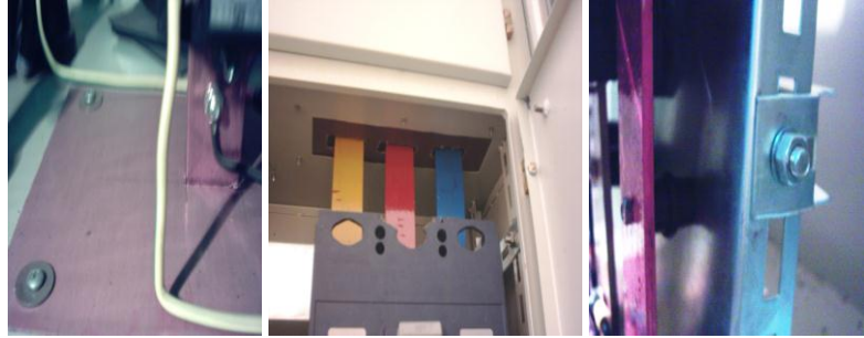
Resim 1.6: Bara yalıtma fiberi, baraların geçişi ve panoya izolatörle sabitlenmesi
