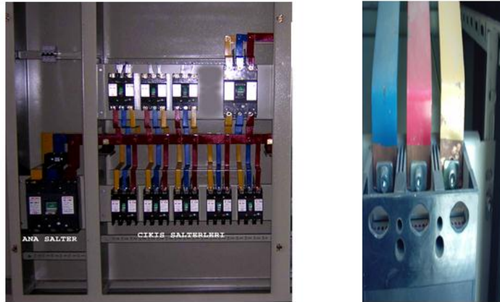
Resim 2.5: Ana dağıtım panosu kompakt şalterleri
