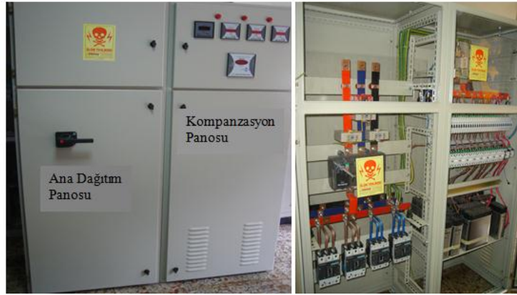
Resim 2.1: Ana dağıtım ve kompanzasyon panosu
