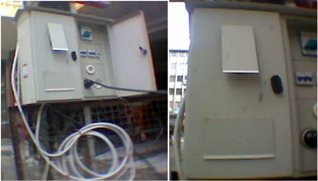
Resim 1.31: Elektrik direğine tutturulmuş bir şantiye tablosunun sayaç kısmı
