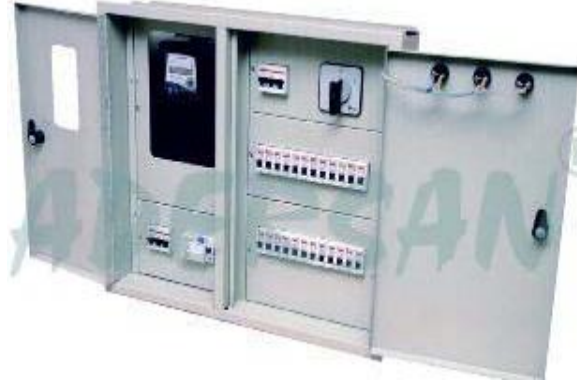
Resim 1.1: Aydınlatma dağıtım tablosu
