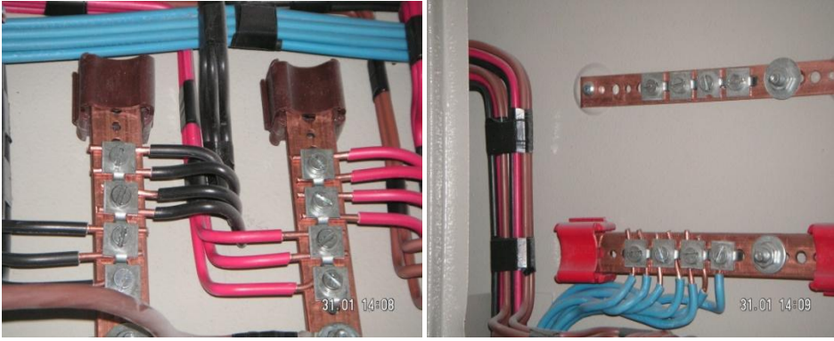
Resim 2.14: Baralara yapılan bağlantılar
