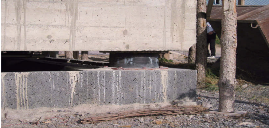
Resim 2. 7: Bir binanın köşe kolonunun altında uygulanmış kauçuk sismik izolatör
