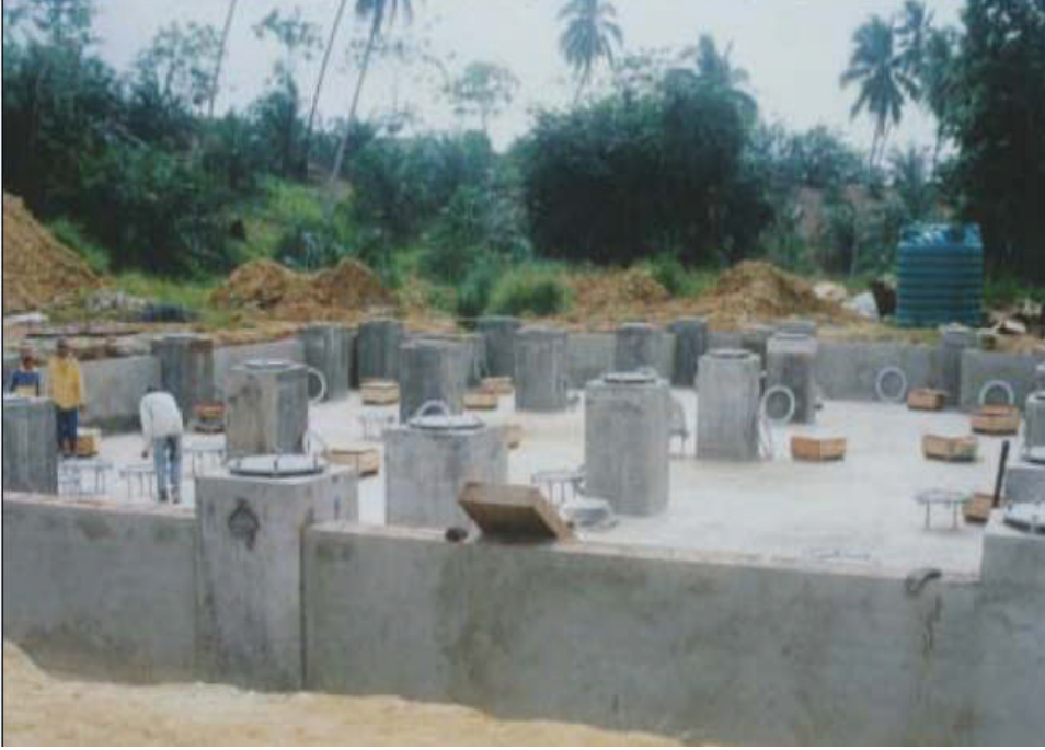
Resim 2. 6: Temel üstünde, kolon ortalarında uygulanmış kauçuk sismik izolatör sistemi
