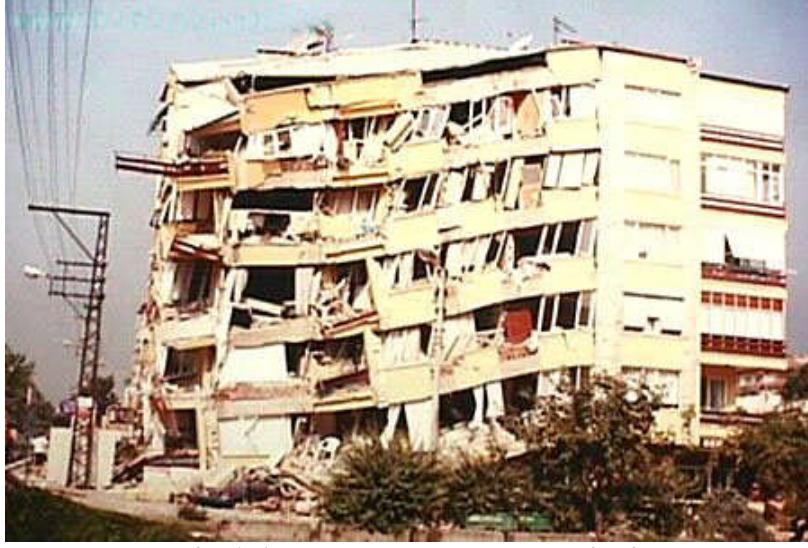
Resim 1. 1: Depremde hasar görmüş bir bina
