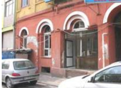
Resim 1.3: Nemden etkilenmiş bina
