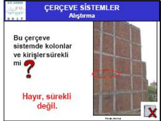
Resim 2.3: Hatalı çerçeve sistemli yapı
