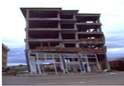
Resim 1.8: Depremde hasar görmüş inşaat hâlindeki bina
