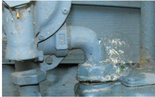
Resim 2.4: Sızdırmazlığı sağlanmamış malzeme
