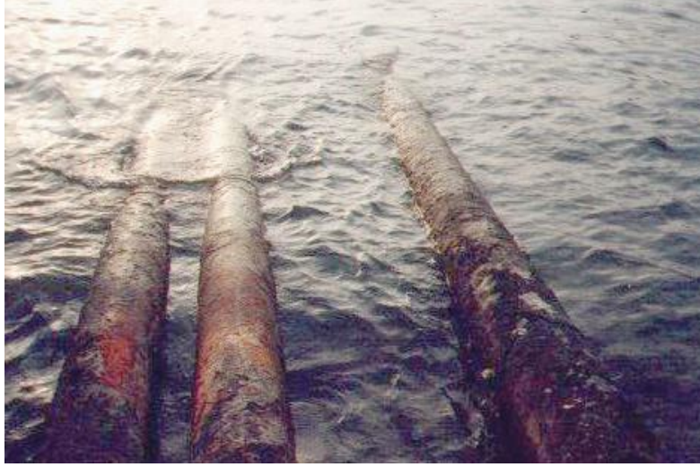
Resim 2.2: Korozyona uğramış boru
