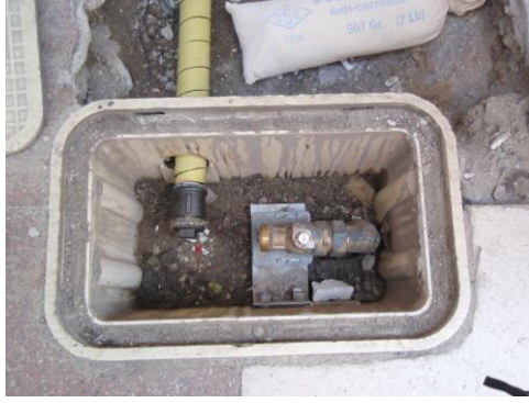
Resim 1.6: Gömülü tip servis kutusunda bina bağlantı hattının yapılması
