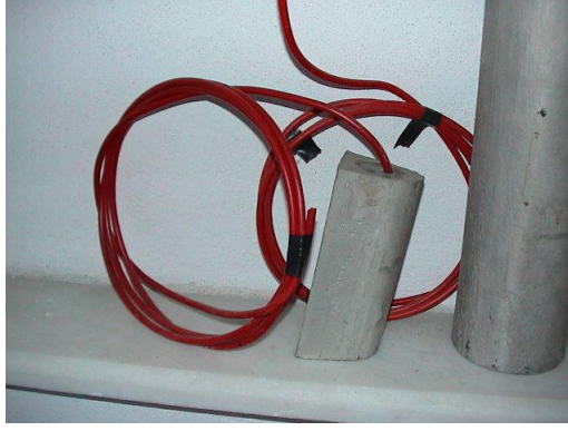
Şekil 2.1: Çelik borulara uygulanan katodik koruma uygulaması
