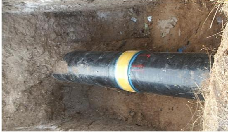
Resim 2.1: Tadilat yapılmış doğal gaz borusu
