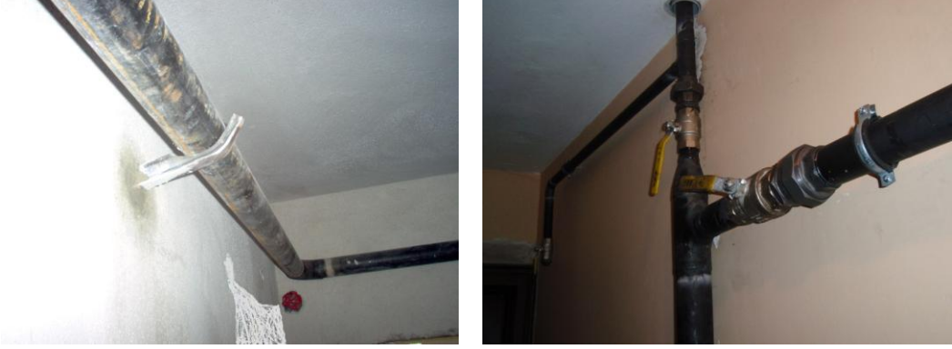
Resim 1.6: Bina ana gaz dağıtım boruları destek elemanları
