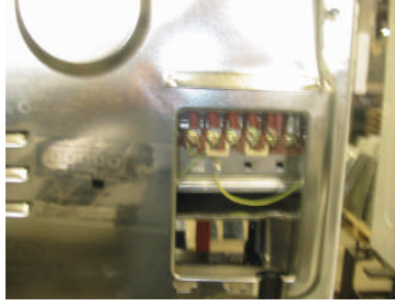
Resim 6.1: Fırının elektrik bağlantısı
