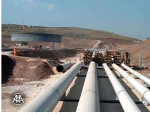
Resim 1. 24: Boru hattı ulaşımı
