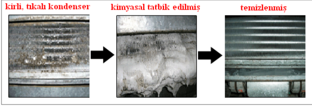
Resim 2.9: Kimyasal temizleyiciler ile temizlenmiş kondenser
