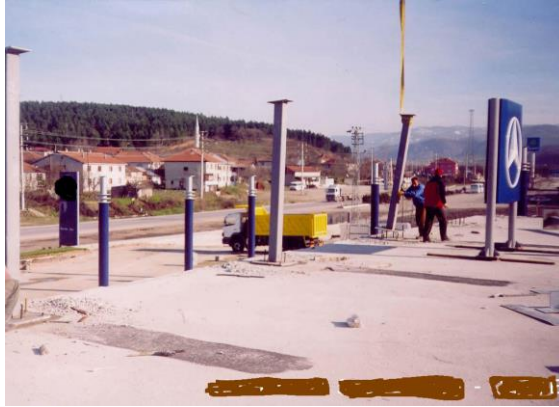
Resim 2.2: Yapılan bir inşaat alanında sütun düşmesi
