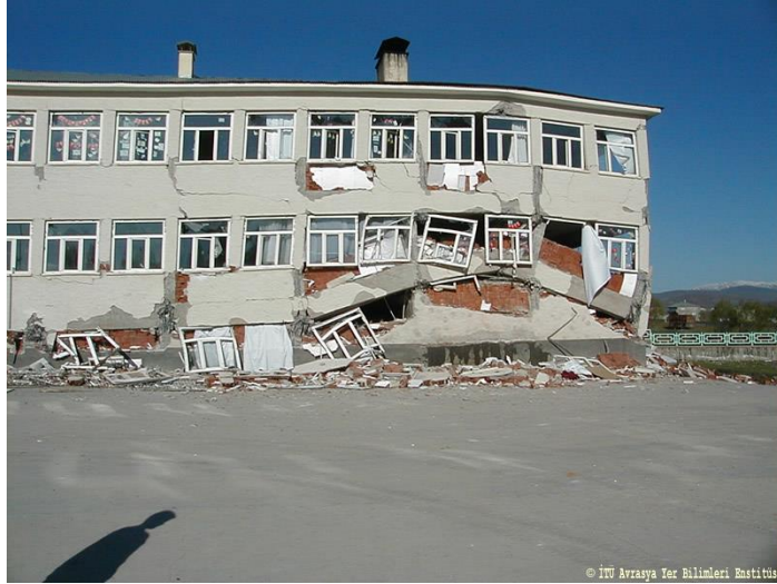
Resim 1.3: Deprem sonucu hasar görmüş bir bina
