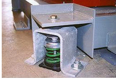
Resim 5.6: Soğutma kulesi titreşim yayı bağlantıları
