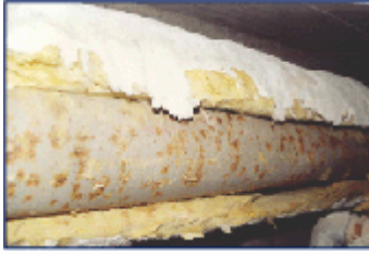
Resim1.17: Yoğuşma sonucu kanalın yalıtımının deformasyonu
