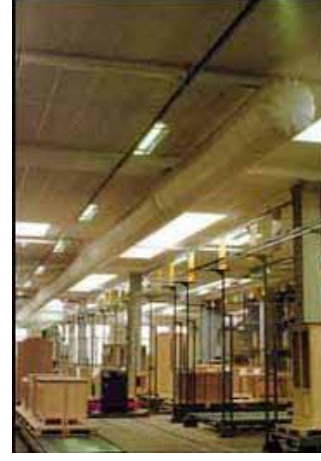
Resim 2.7: Tekstil hava kanalı uygulaması
