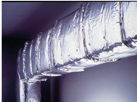
Resim 4.10: Yalıtım yapılmış hava kanalı
