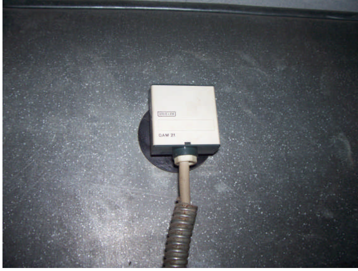
Havalandırma kanalına montajı yapılmış kanal tip nem sensörü
