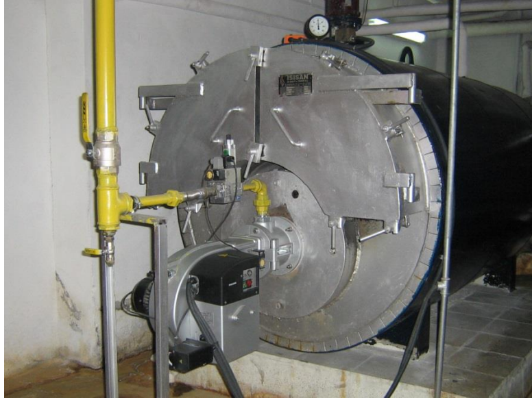
Resim 2 .1: Multiblok gaz hattı
