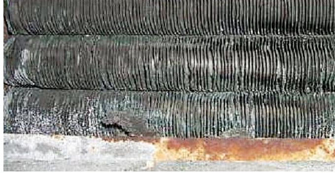
Resim 3.2: Korozyona uğramış kondenser
