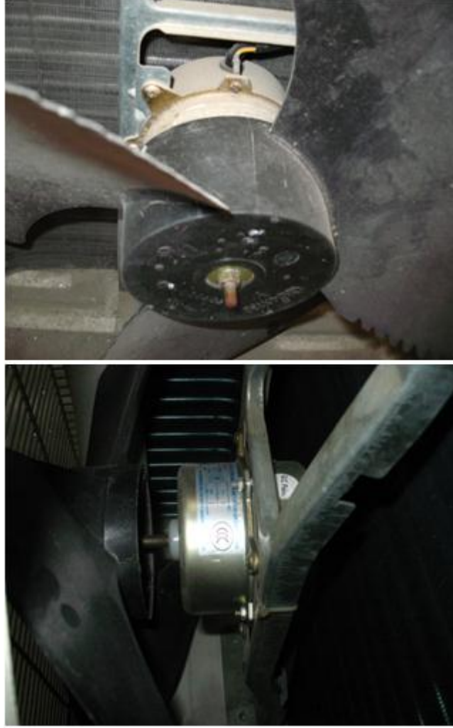
Resim 2.15: Dış üniteye montajlı fan motorları
