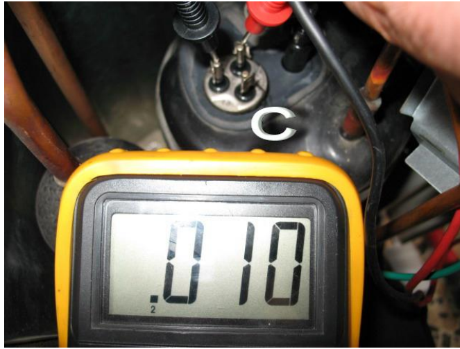
Resim 2.9: Kompresör terminal bağlantı uçlarının tespiti
