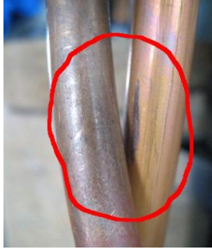
Resim 3.2: Aşırı titreşimin soğutma tesisat borularına zarar vermesi
