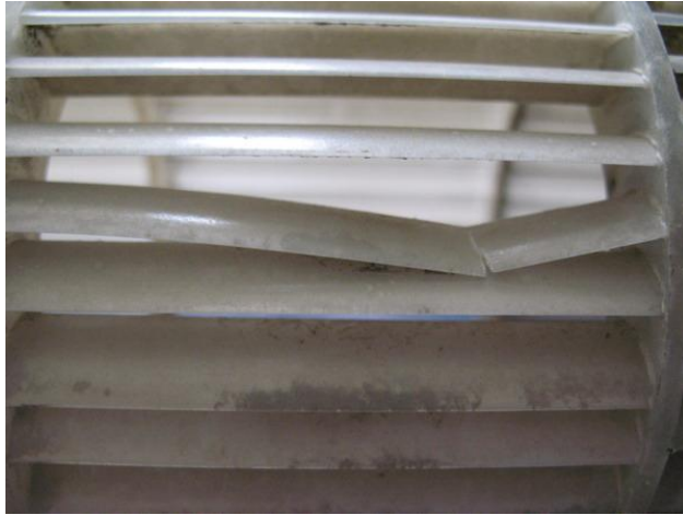
Resim 3.8: İç ünite fan kanadını kırılması neticesinde oluşan arıza
