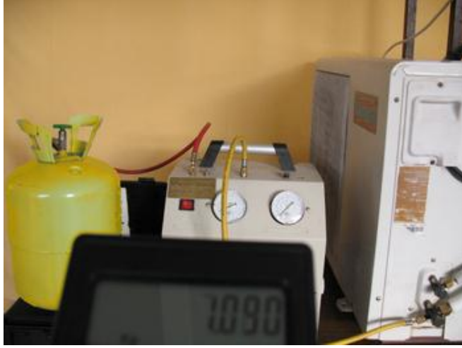
Resim 1.13: Klimalarda soğutucu akışkanın geri kazanım ünitesi ile toplanması
