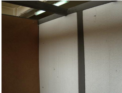
Resim 3.7: Strafor Yerleşimi ve Duralit Kaplama
