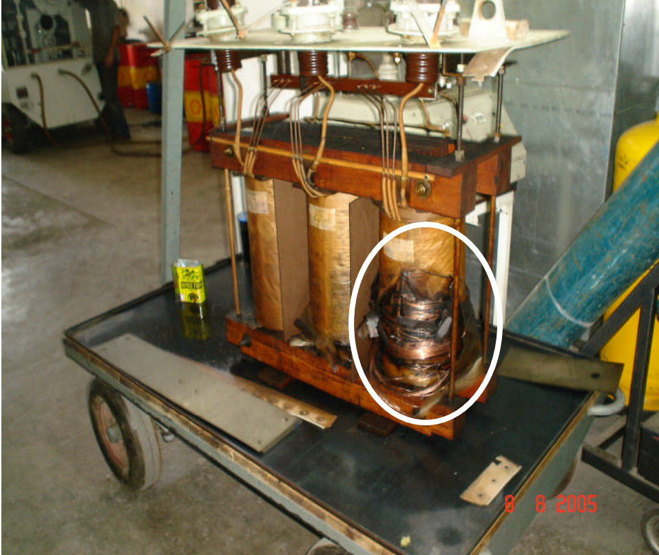
Resim 1. 4: Arızaya gelmiş bir trafo
