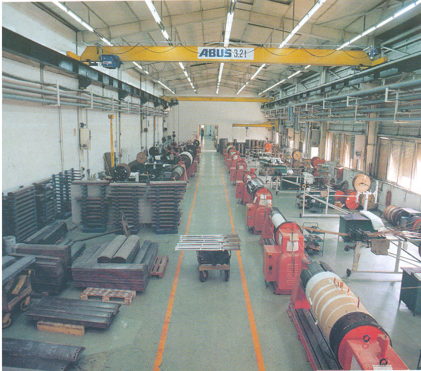
Resim 2. 1: Trafo imalat atölyesi
