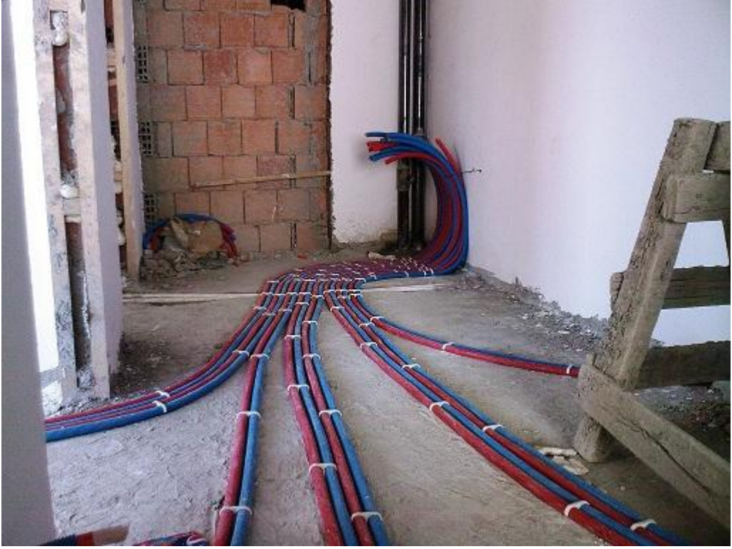
Resim 3.48: Radyatörlü ısıtma sisteminde uygulama
