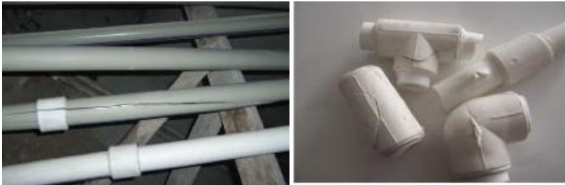
Resim 2.12: Dona uğrayarak çatlamış borular
