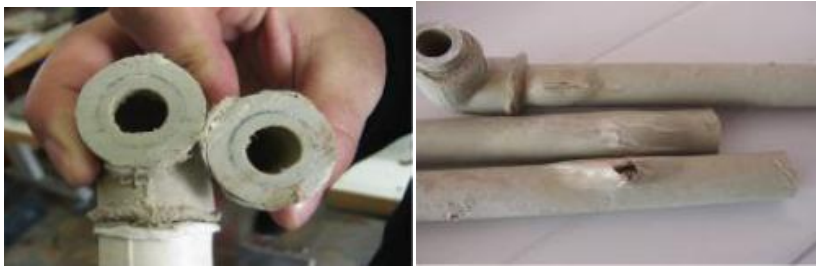
Resim 2.8: Yanlış füzyon kaynağı yapılmış boru parçaları
