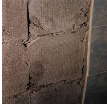
Resim 1. 8: Prizlenme süresinden kaynaklanan hatadan olayı oluşmuş hasar
