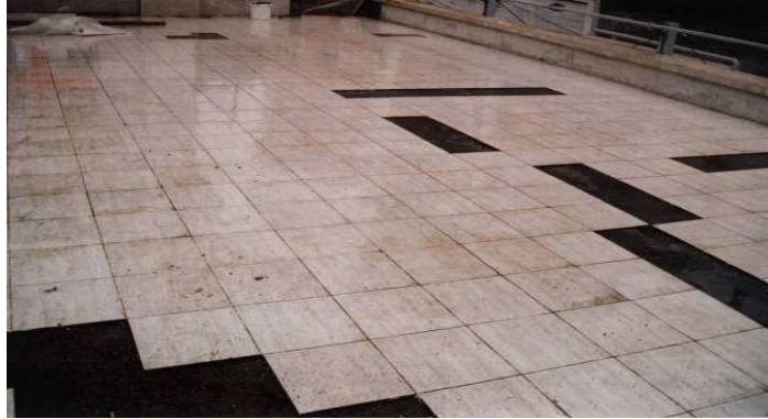
Resim 1.4: İzolasyondan kaynaklanan hata sonucu oluşan hasar
