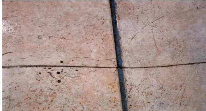
Resim 1.14: Tesisattan kaynaklanan hata nedeni ile sırlı yüzeyi çatlamış seramik karo
