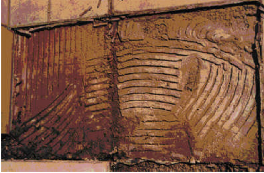
Resim1. 12:Yapıştırma harcı depolanmasından kaynaklanan hata
