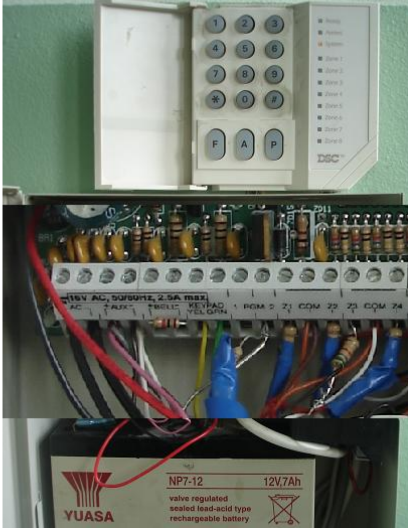
Şekil 3.15: Keypad ve kontrol paneline bağlantısı
