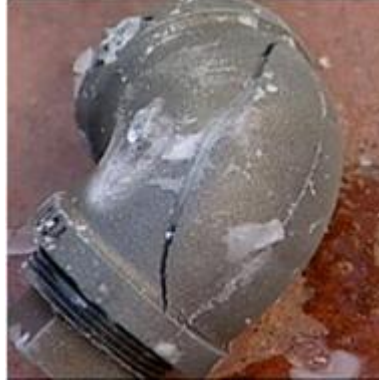
Resim 2.33: Tesisatta donma sonucu oluşan hasar
