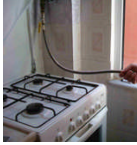
Resim 1.2: Ocaklı fırın gaz bağlantısı
