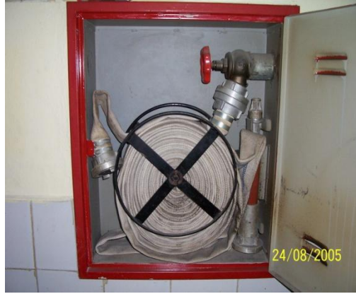
Resim 2. 3: Vana kontrollü yangın dolabı
