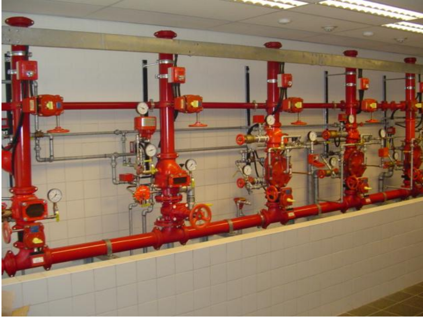
Resim 3.1: Vanalı Yangın tesisatı
