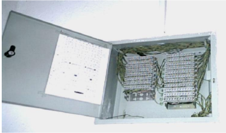
Resim 2.8: Bina ana giriş terminal kutusu ve terminal bloğu bağlantısı
